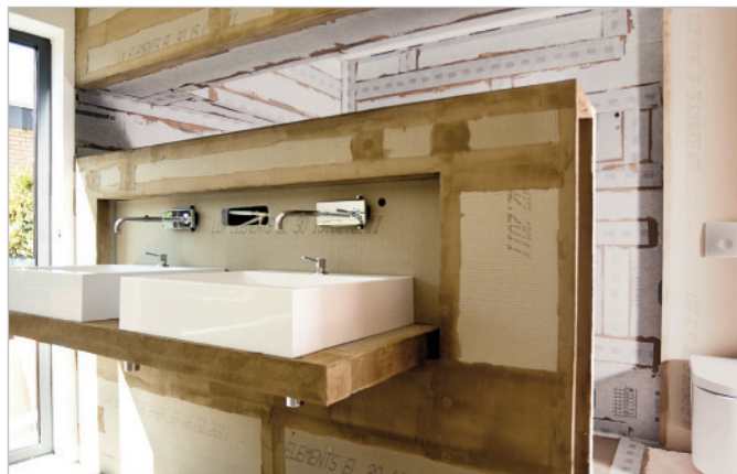
■ La paroi intermédiaire fait appel à deux types de panneaux prêts à carrelier ayant chacun leurs propriétés techniques. À l'arrière, côté douche, c'est le panneau pré-étanchéifié en usine et pare-vapeur LUX ELEMENTS®-ELEMENT-VK qui est mis en œuvre.
