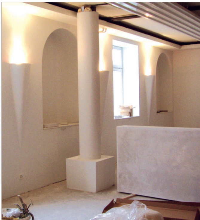
■ ... alle Träger, Säulen und Trennwände wurden mit den feuchtigkeitsresistenten Hartschaum-Trägerelementen von LUX ELEMENTS verkleidet.
